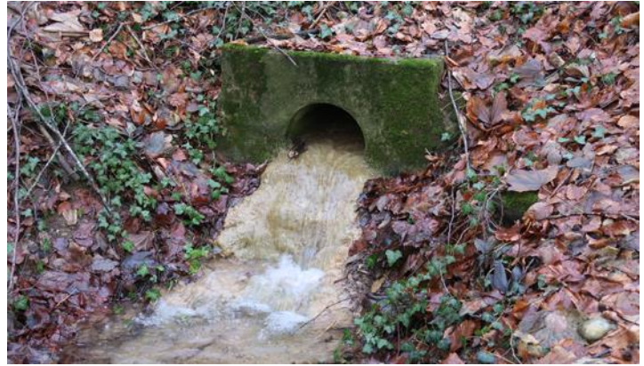
Austritt des Wassers von Rinnsal Süd aus der Unterführung am Waldweg. 15.12.2023
