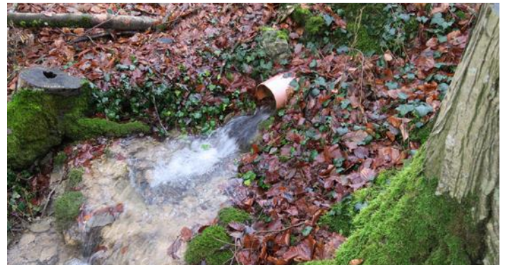
Zufluss-Drainagerohr am Waldrant unterhalb dem Äschenmatthof an der Bergstrasse. 15.12.2023
