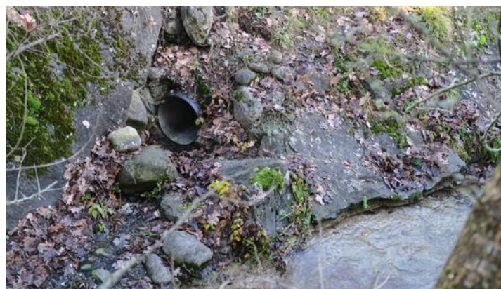
Zuleitung unbekannter Herkunft an der Grabenmattstrasse. 27.12.2023
