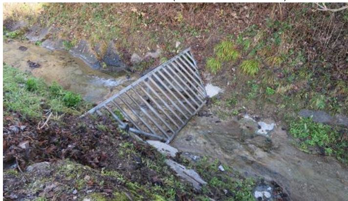
Geschieberechen im Bachlauf. 27.12.2023
