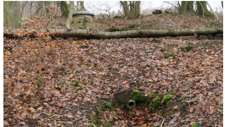
Zweites Drainagerohr unterhalb des Schachtes. 15.12.2023
