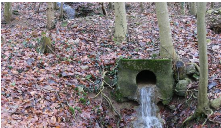
Austritt des Wassers aus der Unterführung am Waldweg. 15.12.2023
