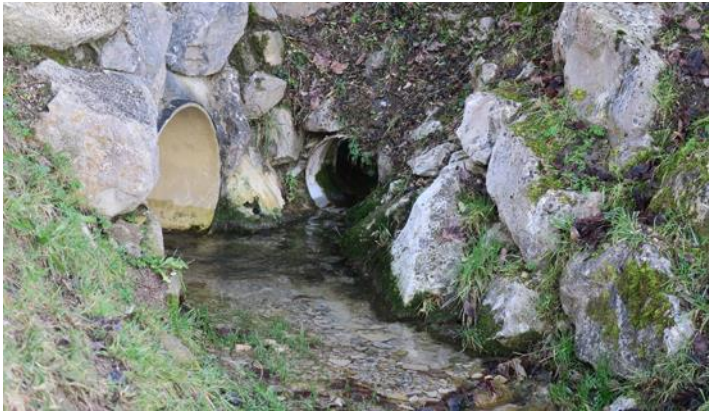
Zufluss des eingedolten Wassers vom Buechstockwaldrand (li). Die Herkunft des Wassers im Rohr rechts ist unbekannt (nicht im Bachkataster). 27.12.2023
