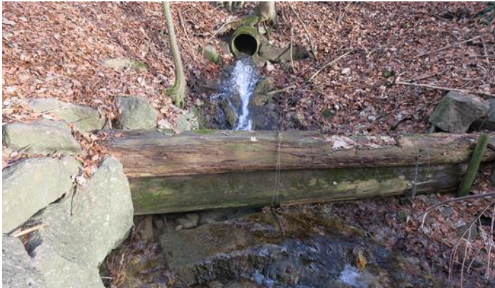
Einlaufrohr der Oberzelg-Dolung im Ifang-Wäldchen. 27.12.2023
