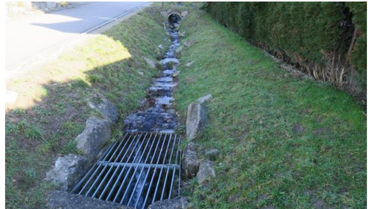
Der untere Bachlauf mit Schacht und Geschiebegitter an der Hinterbächlistrasse. 27.12.2023
